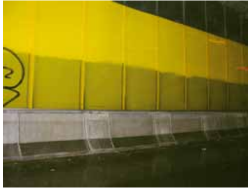
Ondanks de ongunstige condities binnen deze tunnel, brengt het schoonmaken van de zijwanden geen verborgen corrosie aan het licht. Foto: Centro Inox, Milaan (I)
